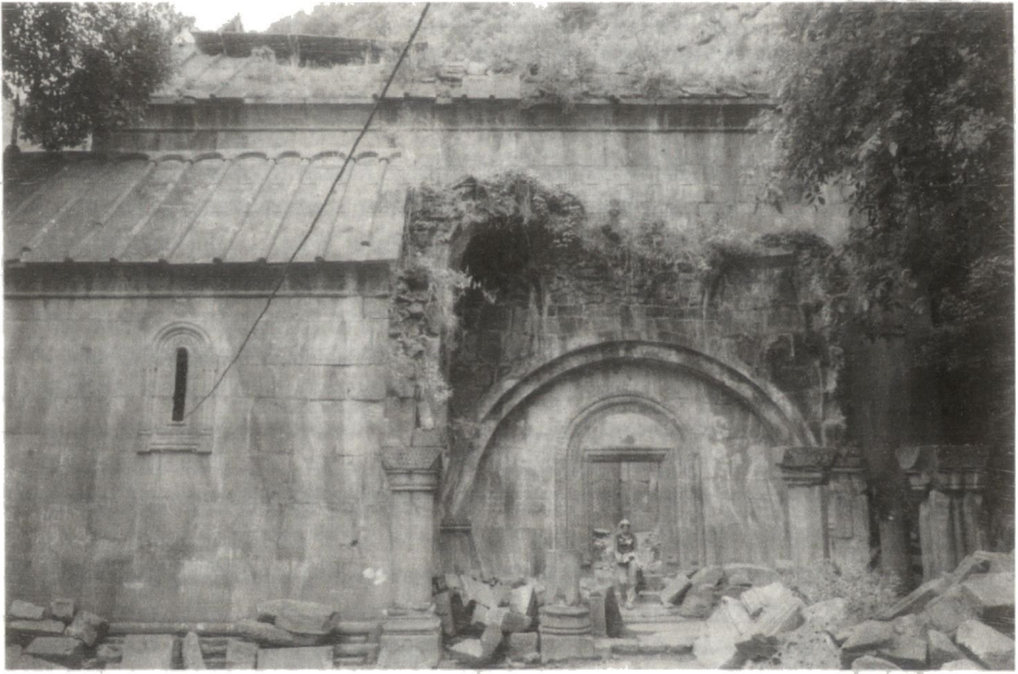
Abb. 2 Nordfassade der Koberi-Kirche, zerfallenes Eingangstor
